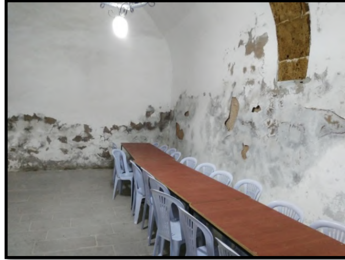
Şekil 29. Hekimhan Kervansarayı kapalı bölümün cephe duvarlarındaki bozulmalar.
