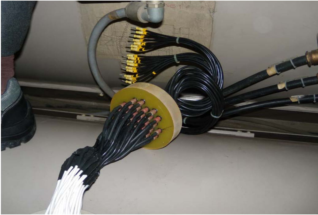
Şekil 6. Diferansiyel koruma rölesine ait adaptör akım transformatörü bağlantı yapısı
